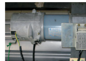
開閉機・ブレーキ装置
