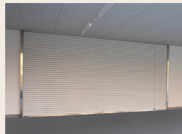
防火・防煙シャッター
