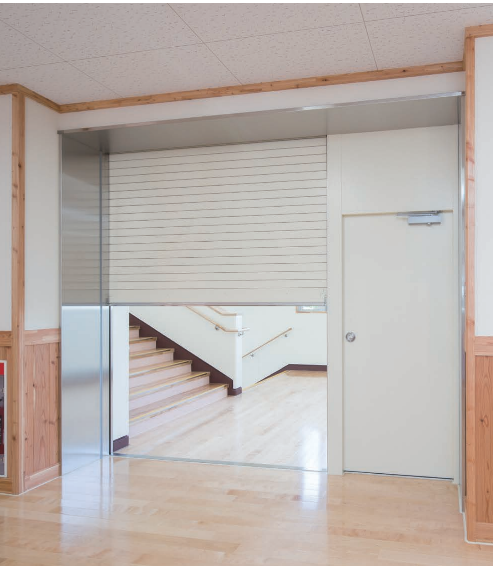
● 防火・防煙シャッター
